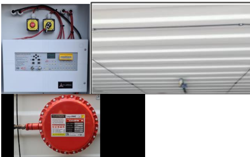
Abbildung 2: Zentrale EP203, Brandmelder und Salgrom SRM-MAG.
