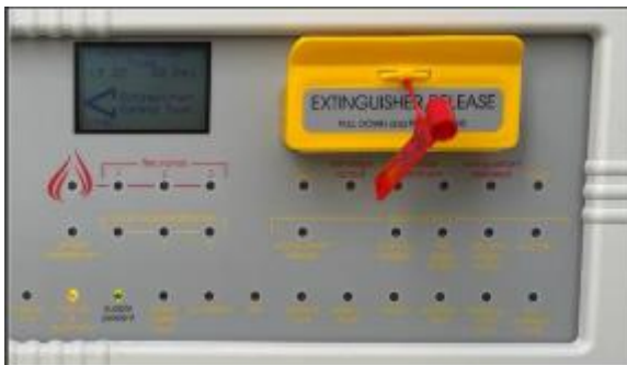
Abbildung 7: Schalter zum manuellen Auslösen des Feuerlöschers
