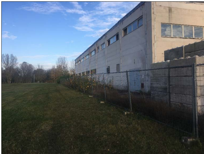
Abbildung 10: An der offenen Dachspalte am Hallengebäude konnten Sperlinge und Rotschwanz beobachtet werden.
